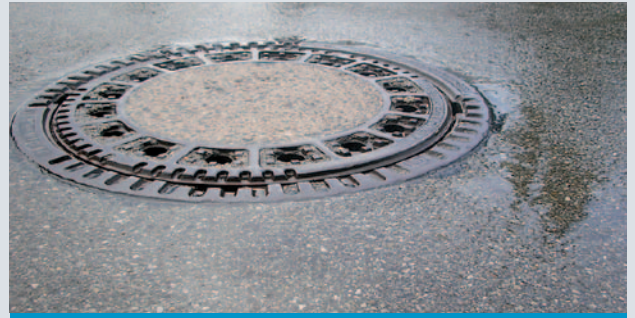
Operaciones de tratamiento de aguas residuales y estaciones de bombeo
