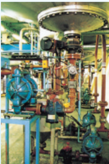
Parte de un proceso de filtración en una importante productora multinacional de pintura donde las bombas Blagdon 50 se utilizan para alimentar la línea de llenado totalmente automatizada.
