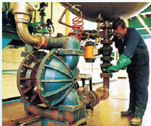
Bomba Blagdon 75 trasvasando pintura del tanque de almacenaje al mezclador.
