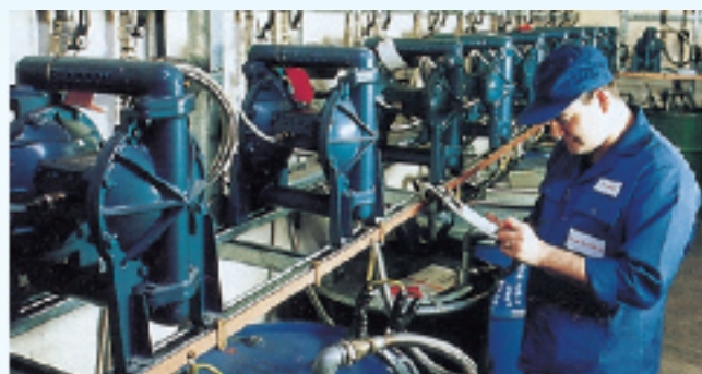
Planta de producción de tinta totalmente automatizada de Rexson. Las bombas Blagdon 25 metálicas se utilizan para la mezcla y recirculación.
