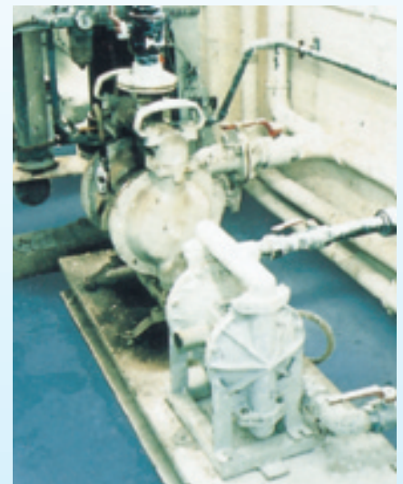
Dos bombas Blagdon en la fábrica de cerámica de Royal Dulton. La unidad en la parte posterior ha bombeado barbotina durante 8 años sin cambio de membrana, válvulas de bola o asientos.
